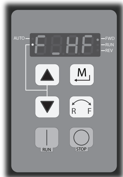
Affichage d'un message d'erreur courant (ici : surtension dans la phase d'alimentation)
